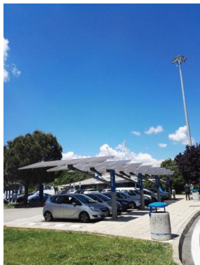
Fot. Panele fotowoltaiczne na stacji benzynowej przy autostradzie
