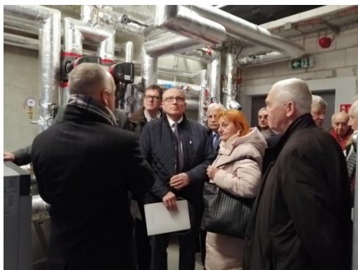
Fot. W kotłowni biurowca BLOCH
